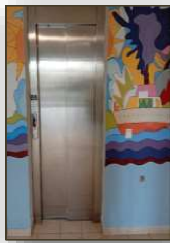
Εικόνα 80. Ανελκυστήρας (Ε.Ε.Ε.Ε.Κ. Λάρισας)
