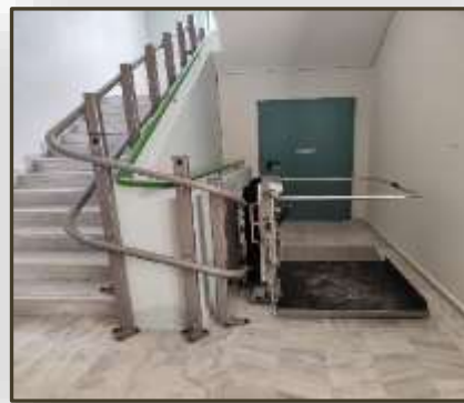
Εικόνα 19. Αναβατόριο κλίμακας με πλατφόρμα (Ειδικό Δημοτικό Ζεφυρίου)
