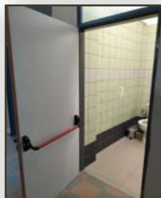
Εικόνα 183. Πόρτα με μπάρα (3° Δημοτικό σχολείο Αμυνταίου Φλώρινας)
